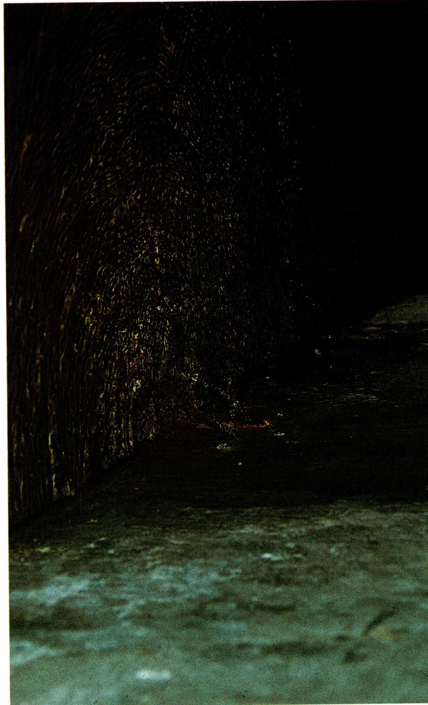
● قبو أحد المباني المتضررة بالمياه الأرضية
