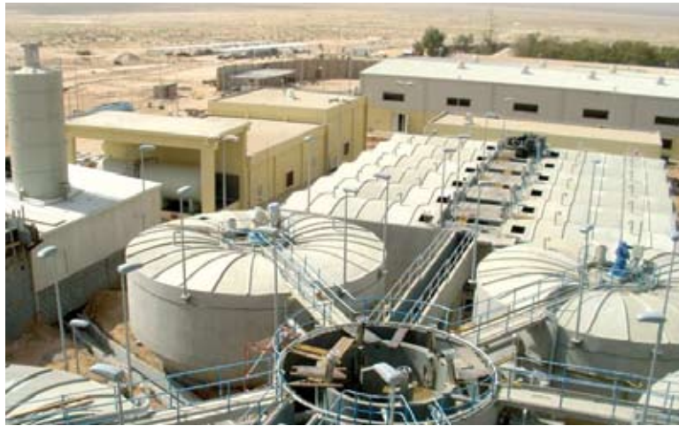
إحدى محطات معالجة مياه الصرف الصحي
